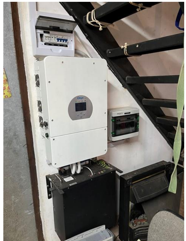
室内に設置したバッテリー
